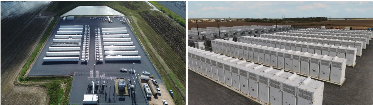
미국 텍사스 남부에 위치한 100MW 규모의 첫 번째 프로젝트 ESS 설비
